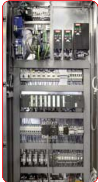
Integrated electric board Armoire électrique intégrée
